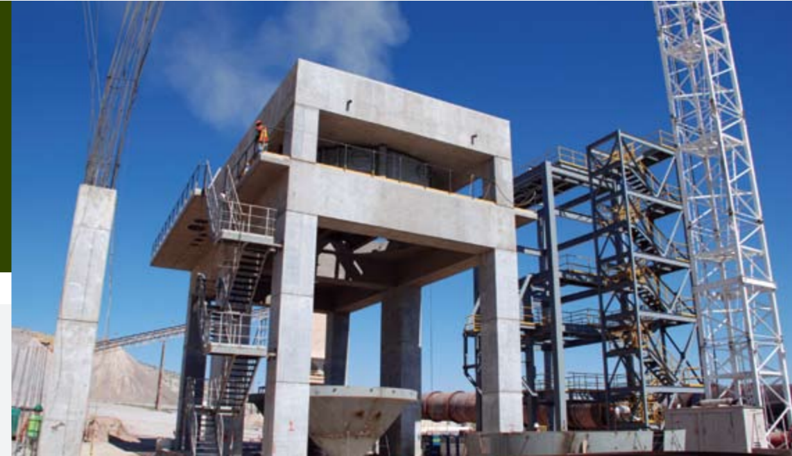
Horno Vertical de la Planta de Cal en Agua Prieta, Sonora.
